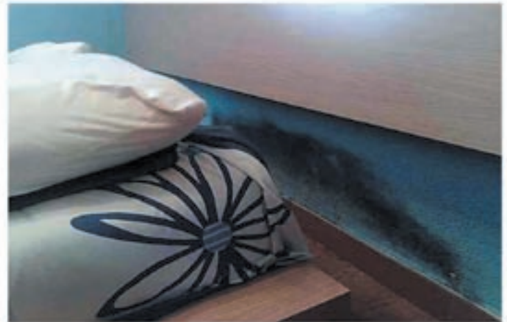
Problemas de humedades por capilaridad
