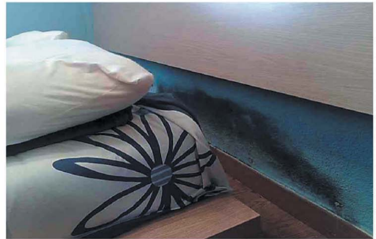
Problemas de humedades por capilaridad
