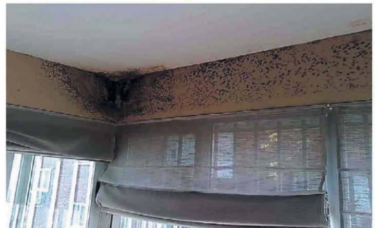
Problemas de humedades por condensación
