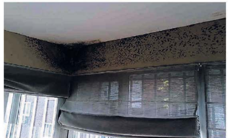
Problemas de humedades por condensación
