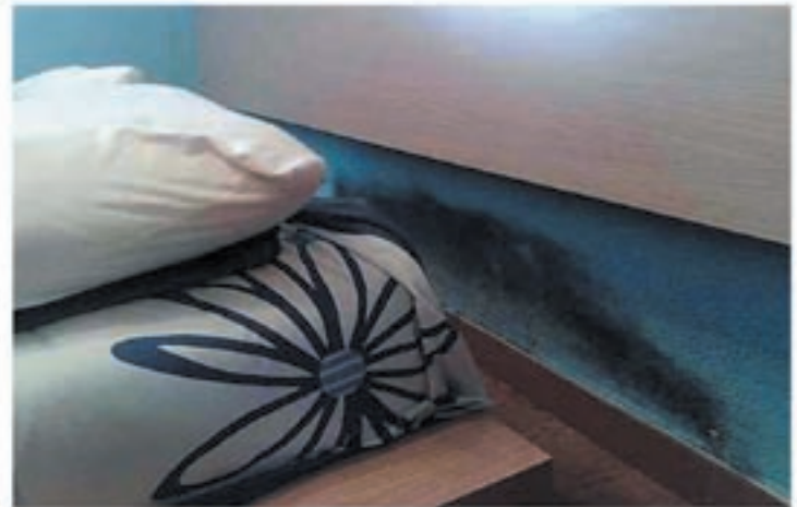
Problemas de humedades por capilaridad
