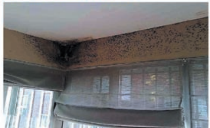
Problemas de humedades por condensación
