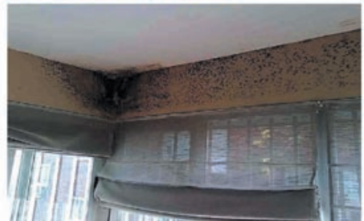
Problemas de humedades por condensación
