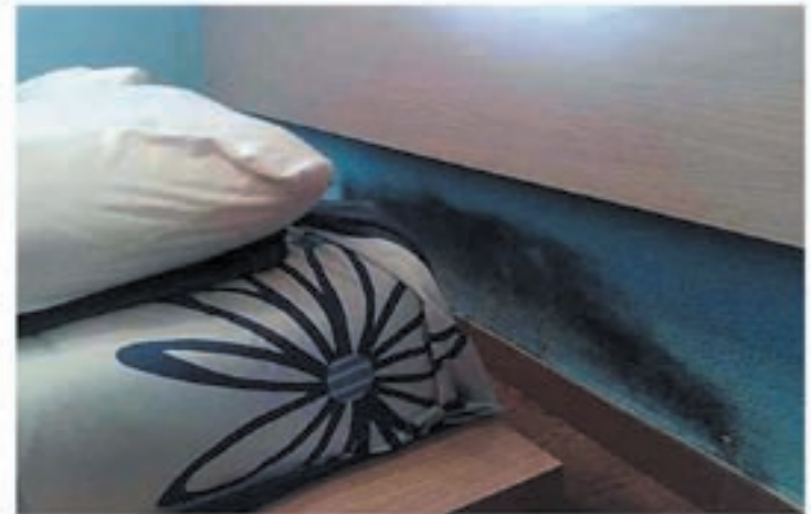
Problemas de humedades por capilaridad
