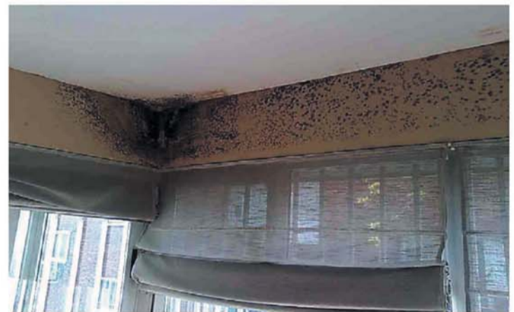
Problemas de humedades por condensación
