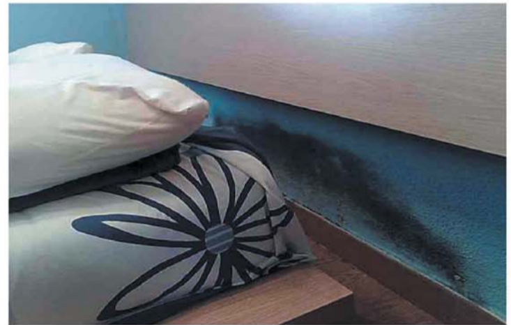
Problemas de humedades por capilaridad
