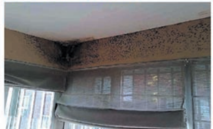
Problemas de humedades por condensación
