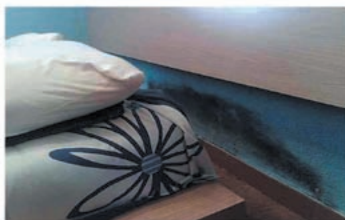
Problemas de humedades por capilaridad
