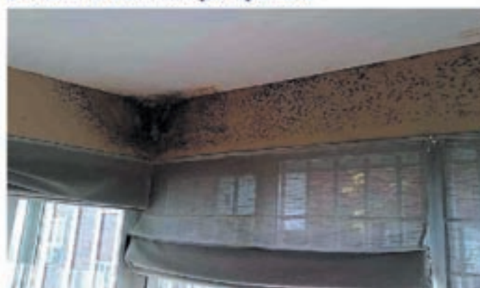
Problemas de humedades por condensación
