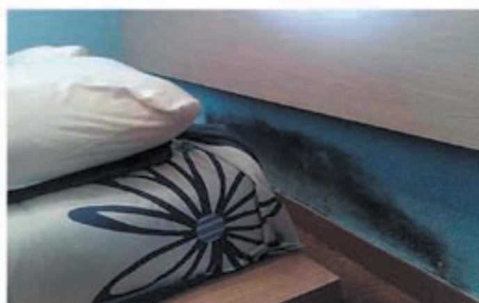
Problemas de humedades por capilaridad
