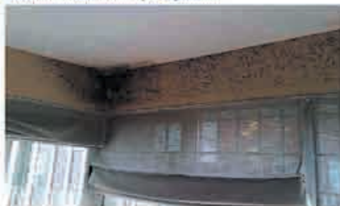
Problemas de humedades por condensación
