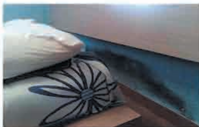
Problemas de humedades por capilaridad
