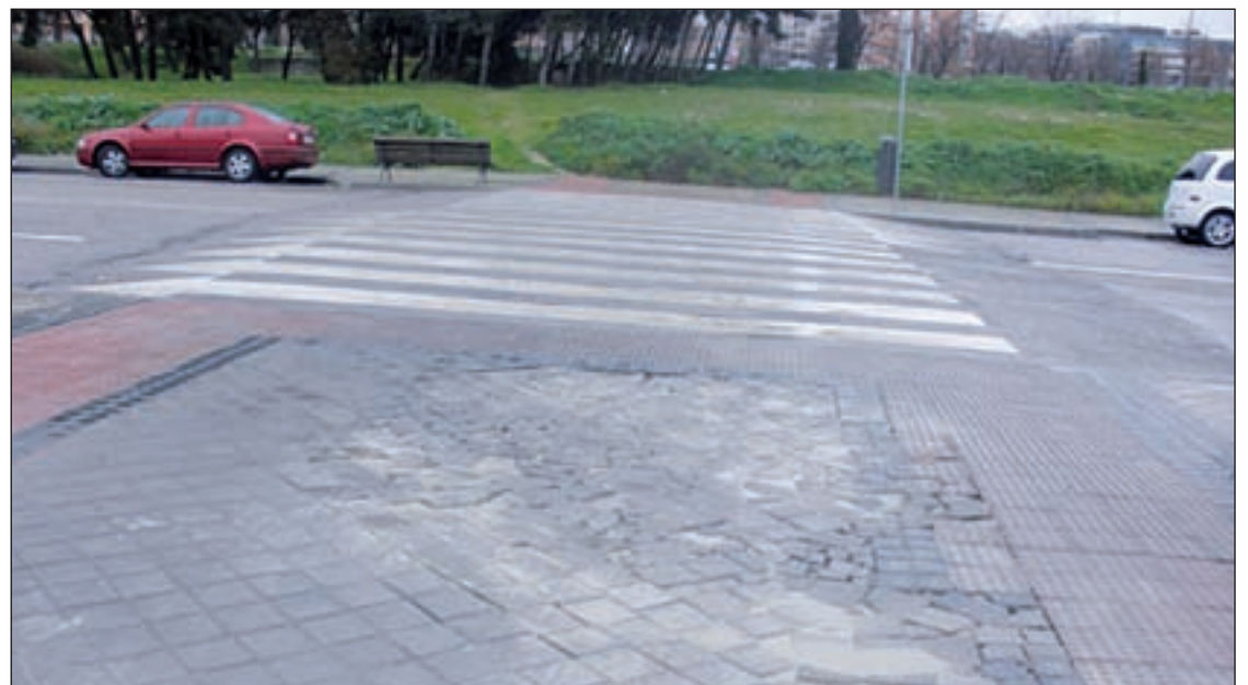
El adoquinado de la zona de acceso muestra su avanzado estado de deterioro
