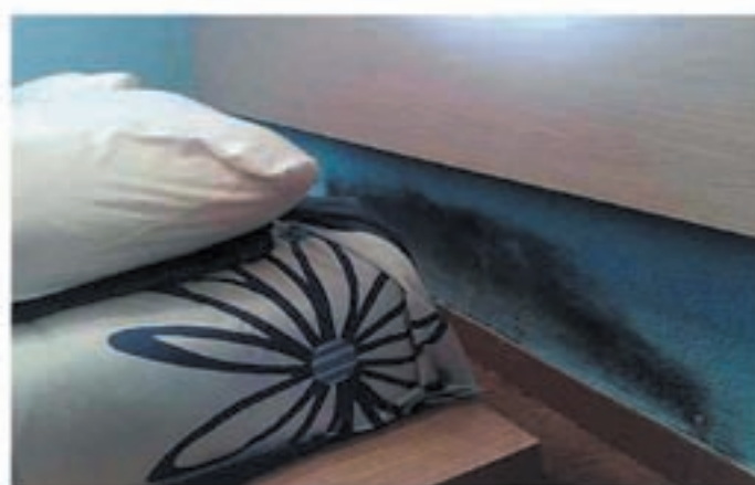
Problemas de humedades por capilaridad
