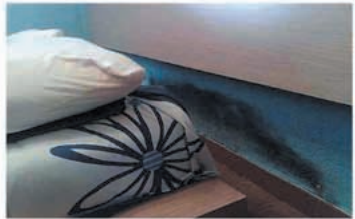
Problemas de humedades por capilaridad
