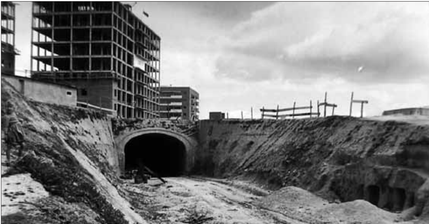
Túnel de acceso a las cocheras de Plaza de Castilla durante su construcción CÉSAR MOHEDAS
