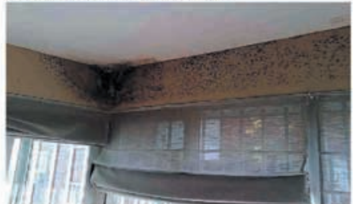
Problemas de humedades por condensación
