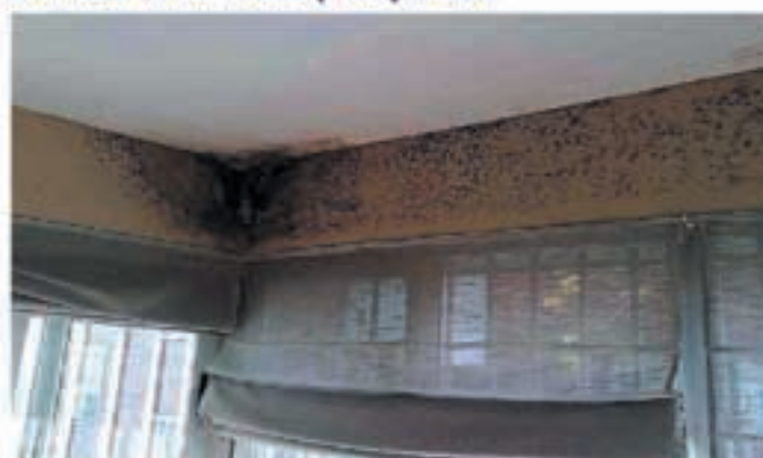
Problemas de humedades por condensación
