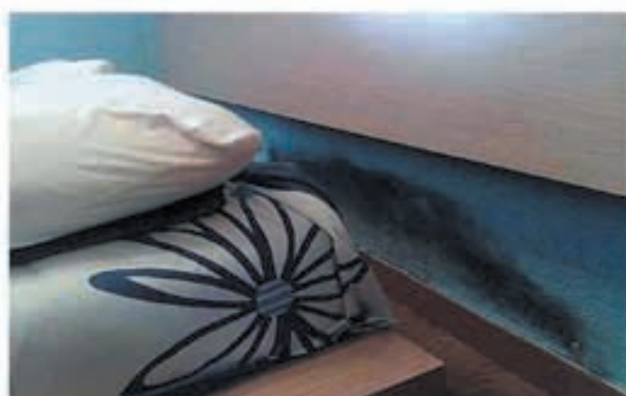
Problemas de humedades por capilaridad
