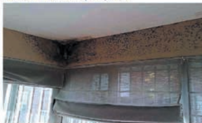
Problemas de humedades por condensación
