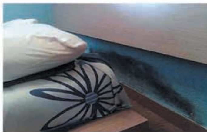
Problemas de humedades por capilaridad
