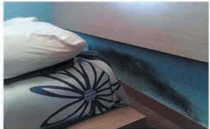
Problemas de humedades por capilaridad
