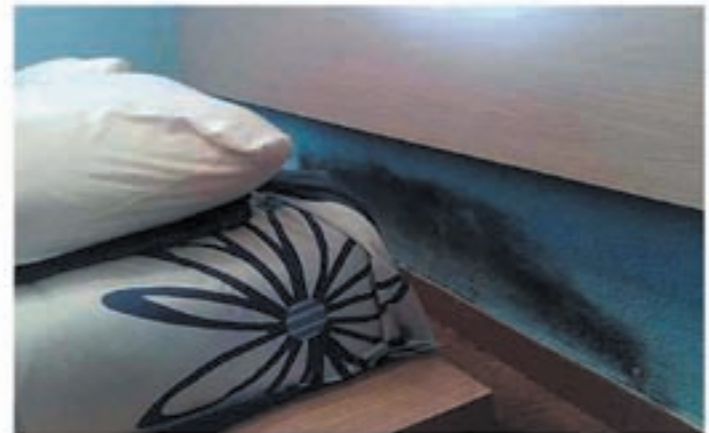
Problemas de humedades por capilaridad
