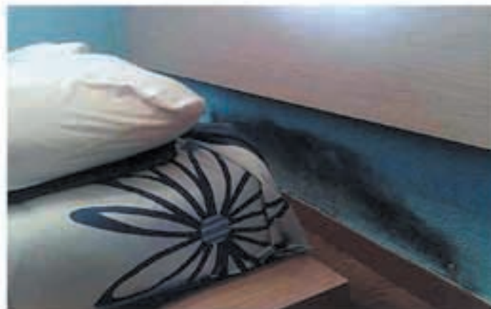
Problemas de humedades por capilaridad
