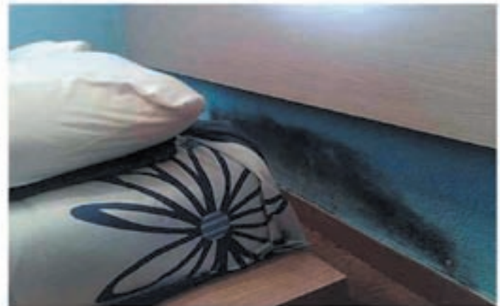
Problemas de humedades por capilaridad
