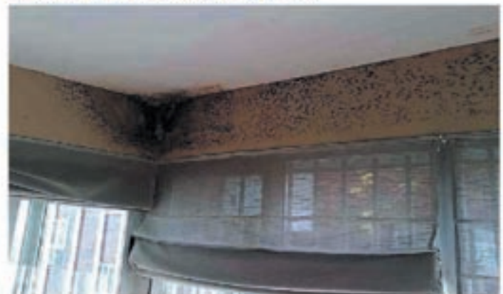
Problemas de humedades por condensación
