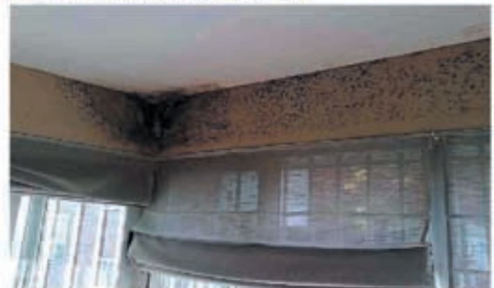
Problemas de humedades por condensación
