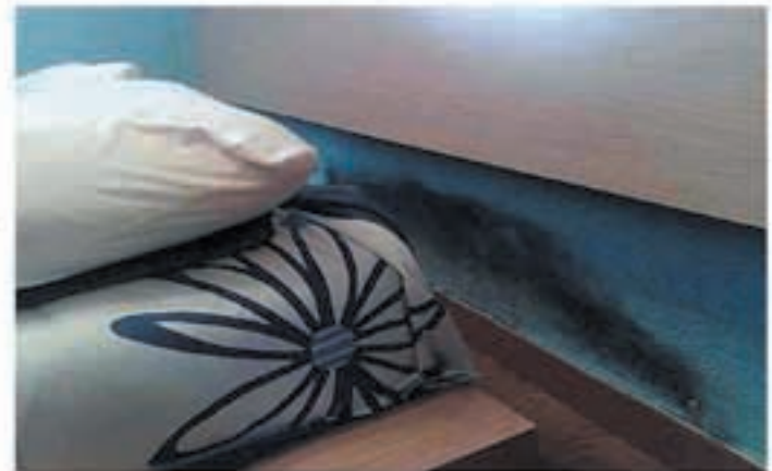
Problemas de humedades por capilaridad
