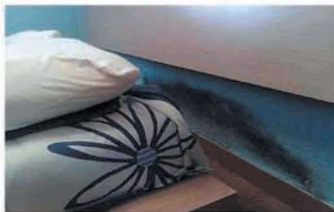
Problemas de humedades por capilaridad
