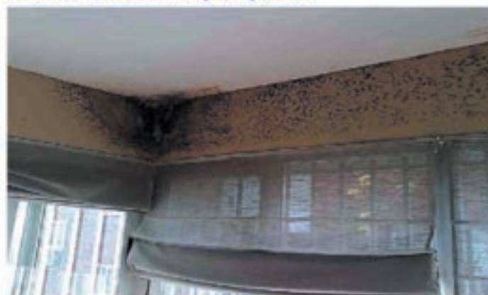
Problemas de humedades por condensación
