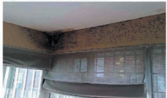
Problemas de humedades por condensación
