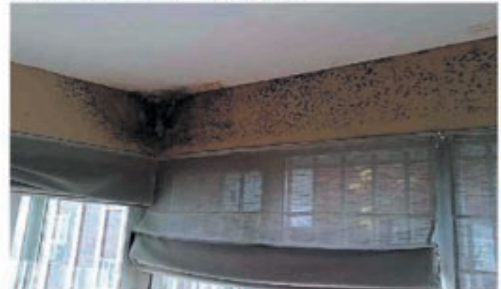
Problemas de humedades por condensación
