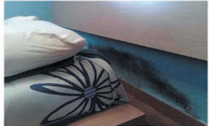
Problemas de humedades por capilaridad
