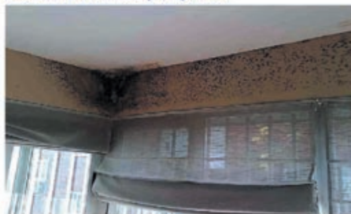
Problemas de humedades por condensación
