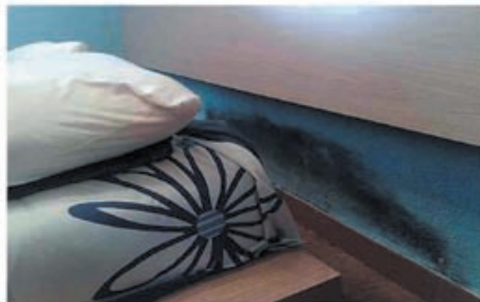
Problemas de humedades por capilaridad
