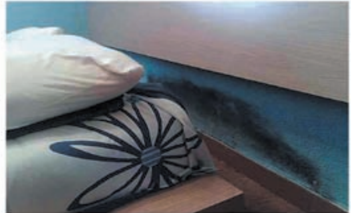
Problemas de humedades por capilaridad
