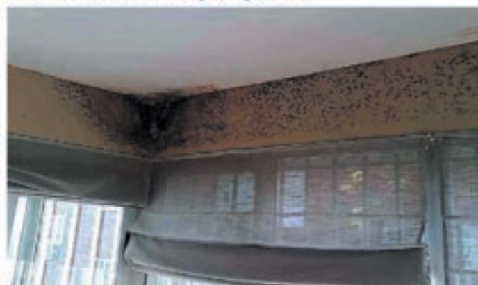
Problemas de humedades por condensación
