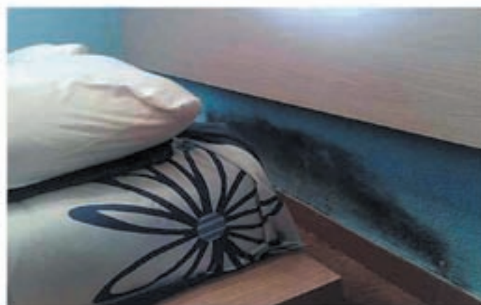
Problemas de humedades por capilaridad
