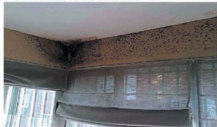
Problemas de humedades por condensación
