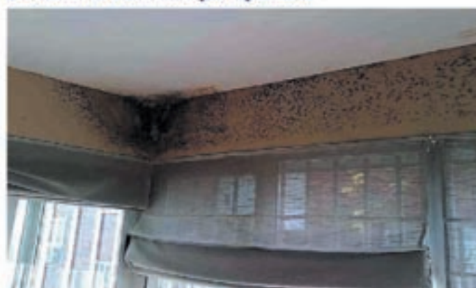
Problemas de humedades por condensación
