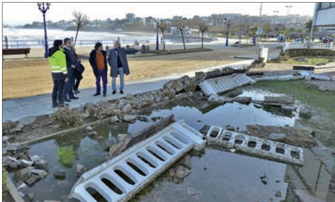
Destrozos provocados por el temporal en Santander
