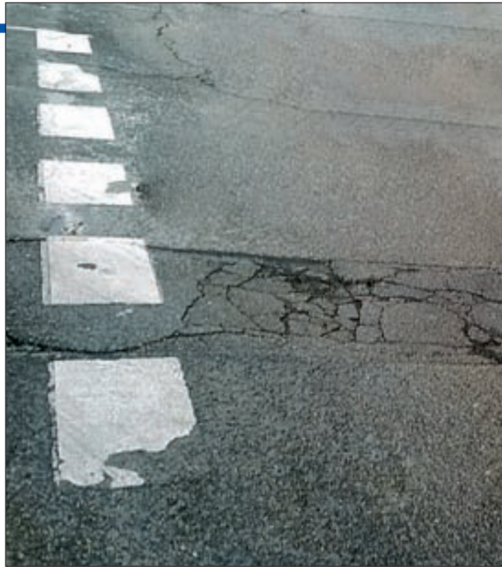
Uno de los baches de una de las calles de El Pozo
