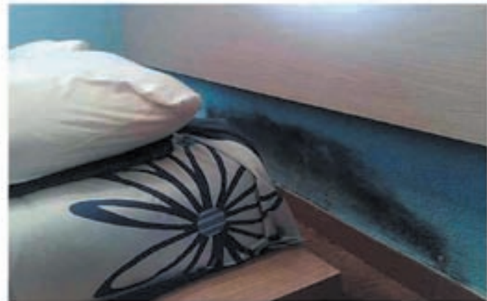
Problemas de humedades por capilaridad
