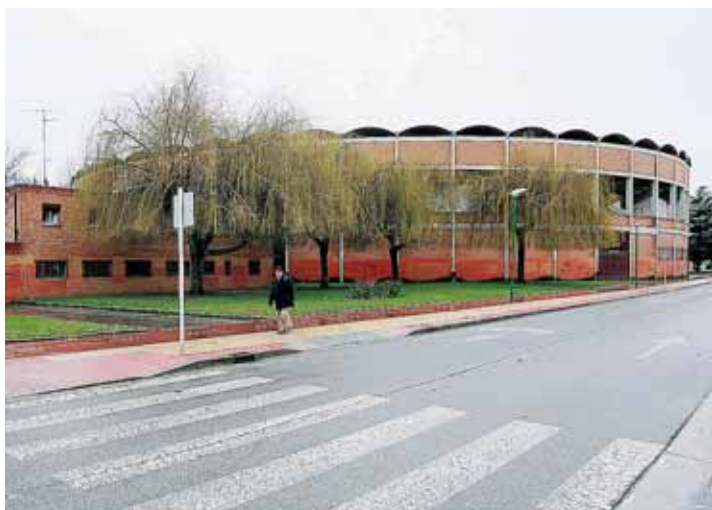
Informes técnicos advierten desde hace dos años del deterioro estructural del coso de El Plantío.
