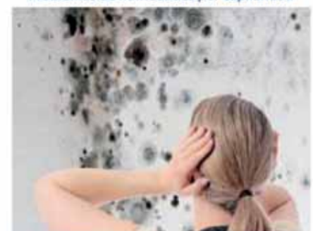
Problemas de humedades por condensación
