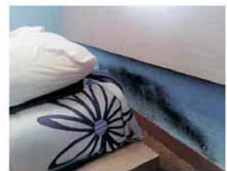
Problemas de humedades por capilaridad
