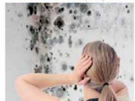
Problemas de humedades por condensación
