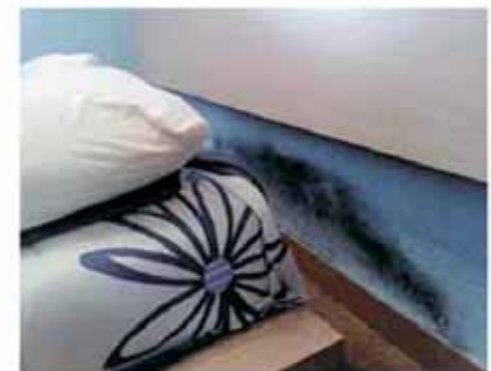
Problemas de humedades por capilaridad
