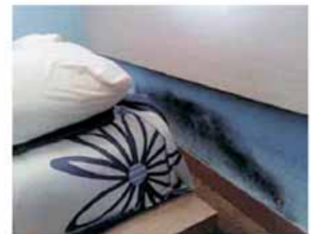
Problemas de humedades por capilaridad
