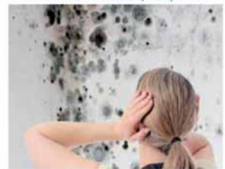
Problemas de humedades por condensación
