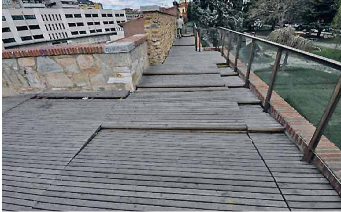
El tramo paseable de la muralla junto al Jardín del Cid presenta numerosos desperfectos.
