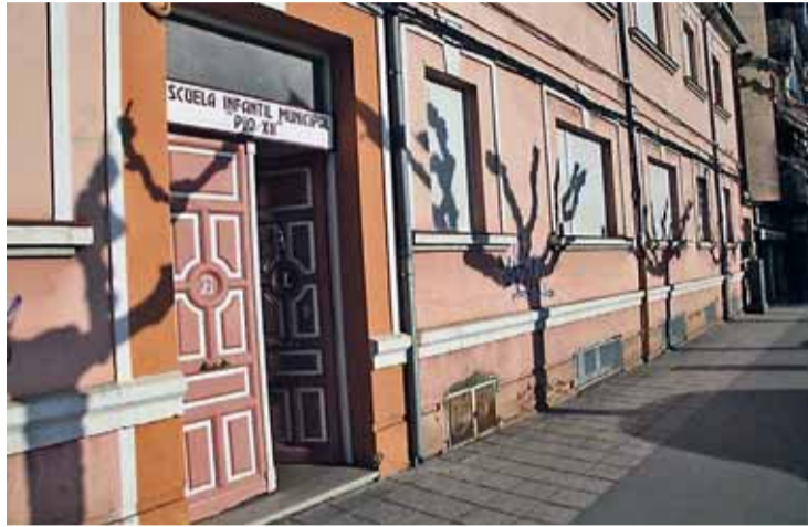
La Escuela Infantil Pío XII, en Mariano Andrés, se cierra por tener unas instalaciones muy deterioradas y ser peligrosa por tener tres pisos con muchas escaleras.
