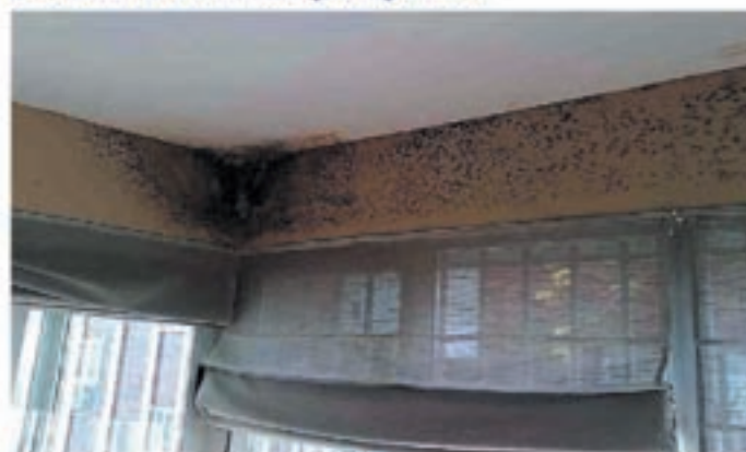
Problemas de humedades por condensación
