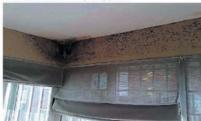
Problemas de humedades por condensación
