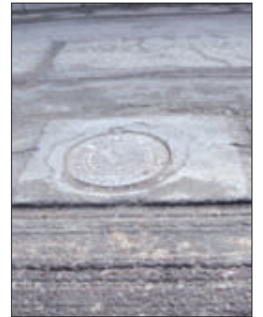
El mal estado de esta avenida
