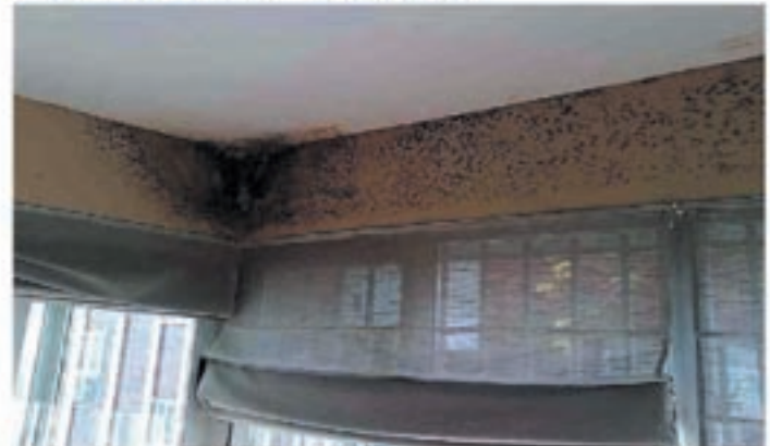
Problemas de humedades por condensación
