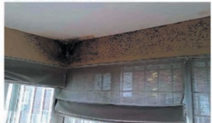
Problemas de humedades por condensación
