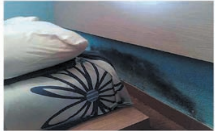
Problemas de humedades por capilaridad
