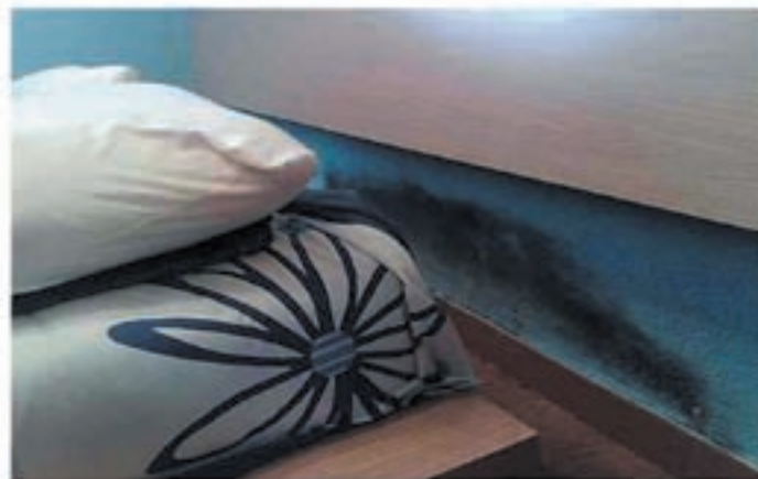
Problemas de humedades por capilaridad
