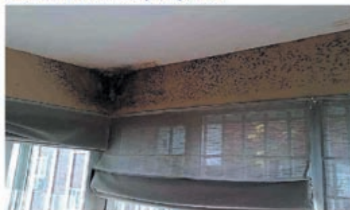
Problemas de humedades por condensación
