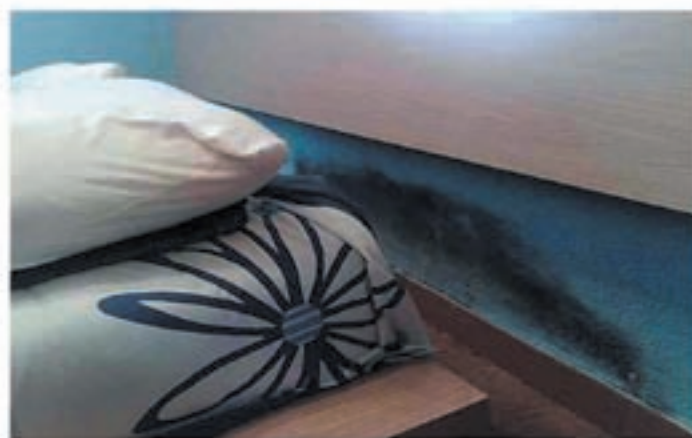
Problemas de humedades por capilaridad
