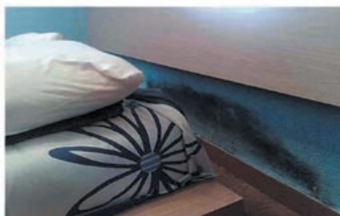
Problemas de humedades por capilaridad
