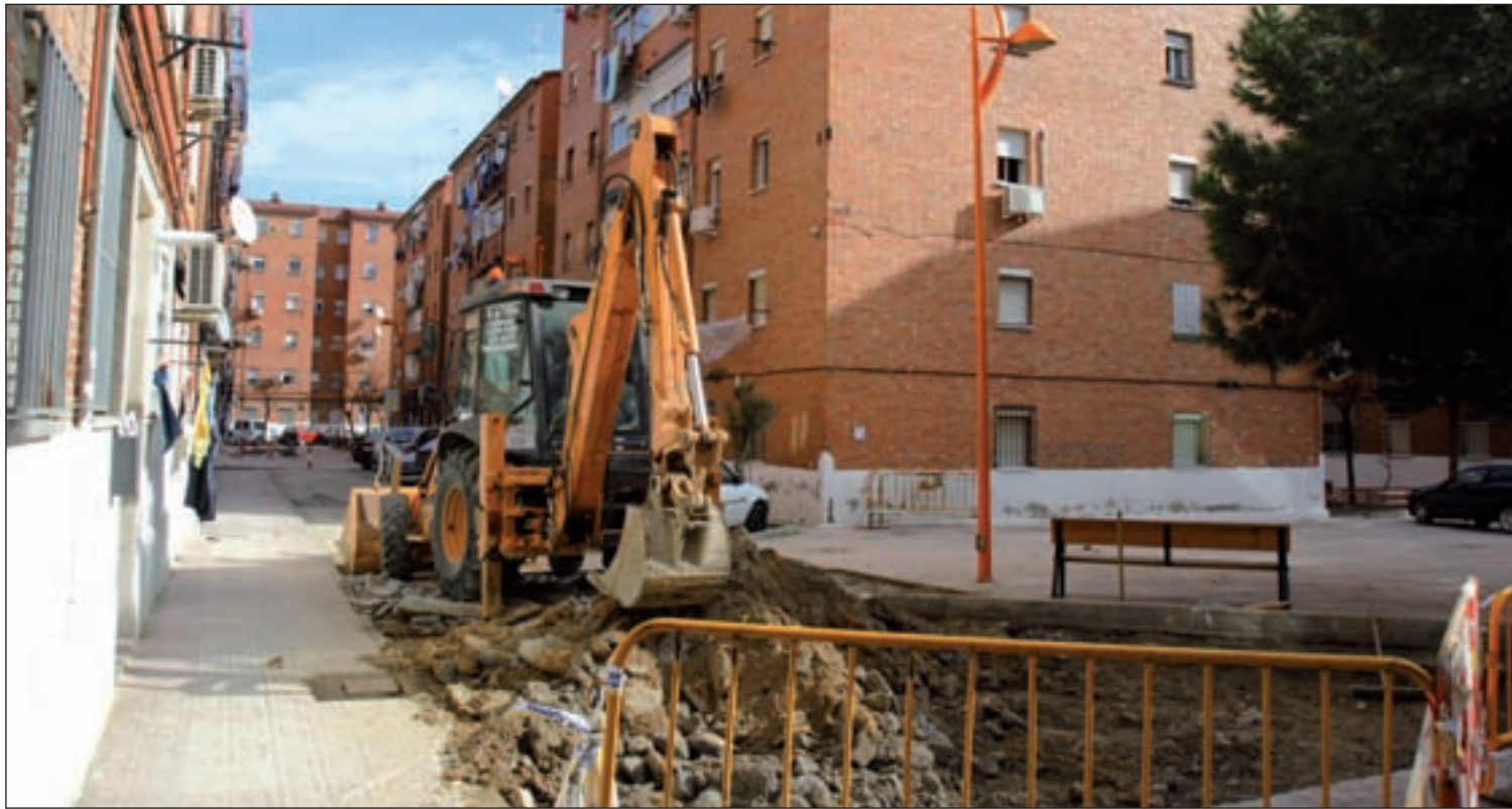
Imagen de una de las obras llevadas a cabo en el barrio por el Ayuntamiento de Getafe
