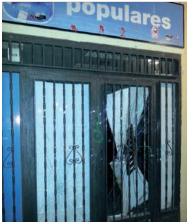
Estado de la sede tras la agresión sufrida recientemente
